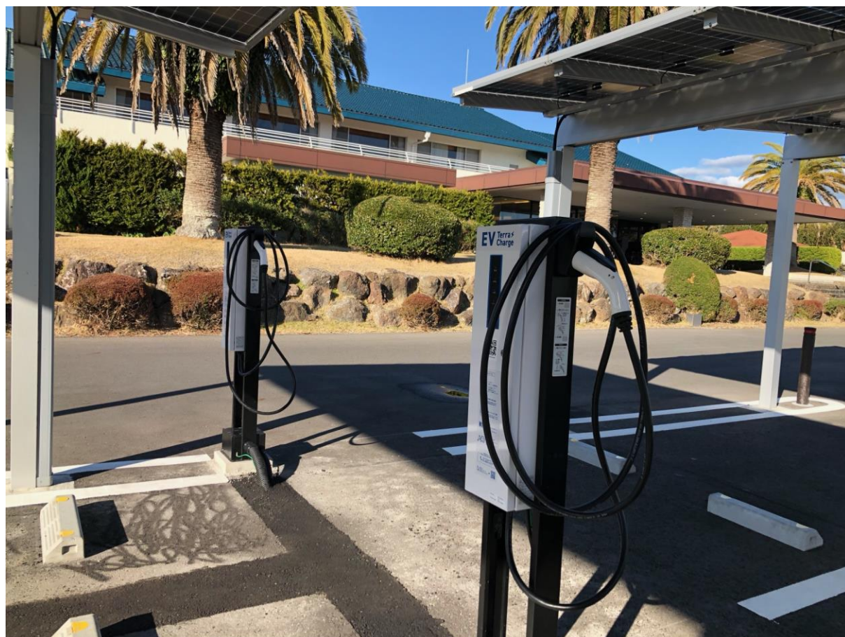
勝浦東急ゴルフコース駐車場に設置した EV 充電器
